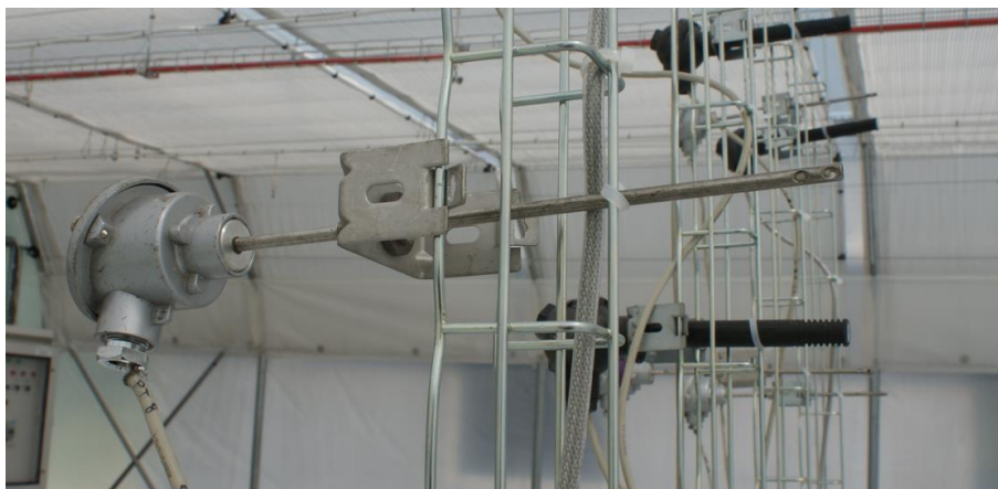
Rysunek 26. Widok czujnika temperatury zamontowanego na siatce pomiarowej - obiekt badawczy URK
